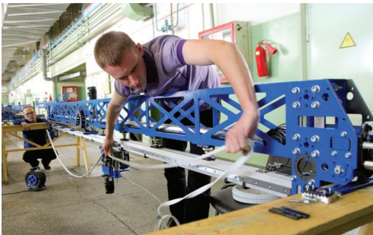
Монтаж элементов активной системы обезвешивания для АО «ИСС им. М.Ф. Решетнева». На переднем плане — ведущий конструктор И.А. Накрохин.
